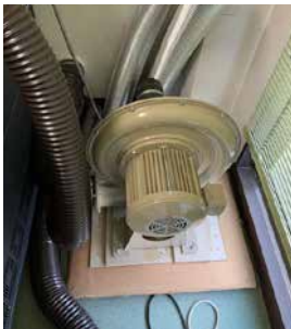
ブロワーの騒音対策として採用（吸音ブラパール）
